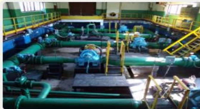
Насосне обладнання ВНС 4-го підйому
